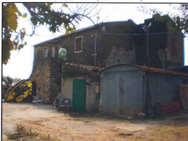
FOTO N ° 101 (EDIFICIO 1)
