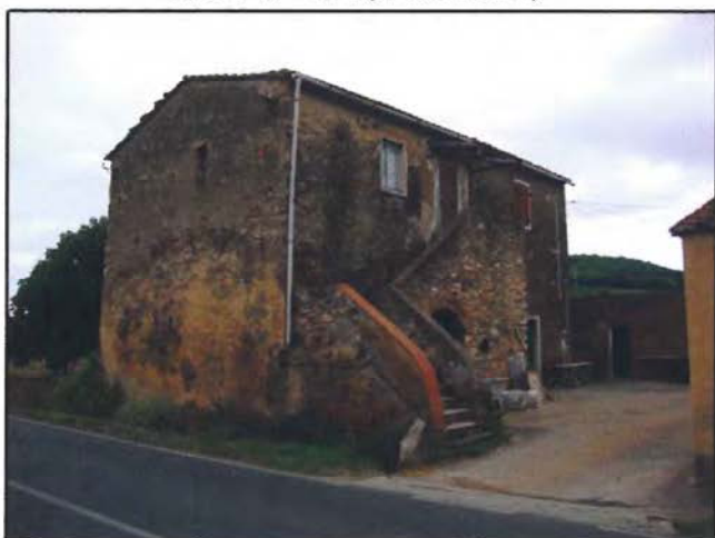
FOTO N ° 104 (EDIFICIO 1)
