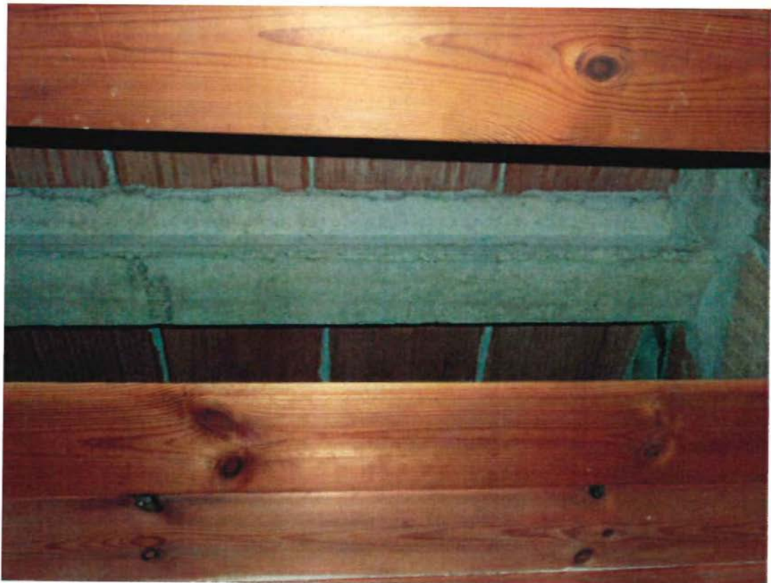
Foto n.8 - Edificio 1b - Interni – Abitazione (sub 3) – P.T. Camera 2 - Particolare soffitto
