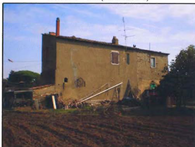
FOTO N ° 103 (EDIFICIO 1)
