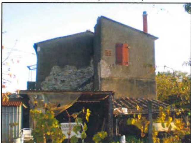
FOTO N ° 102 (EDIFICIO 1)
